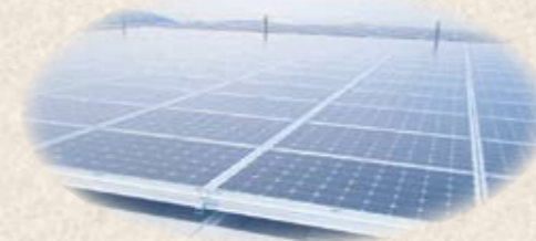
▲太陽光パネル
