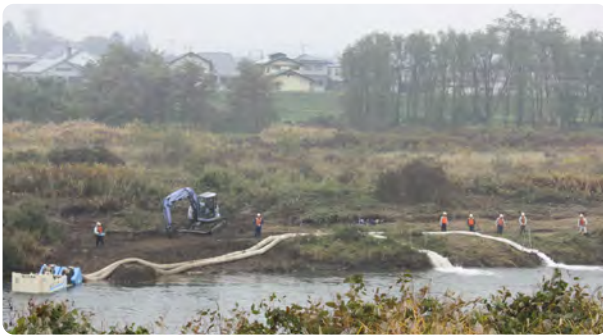
排水ポンプ車による水防訓練
