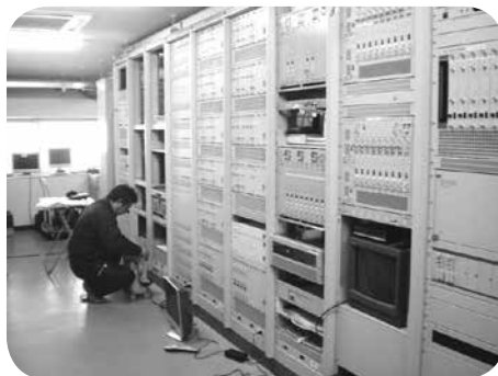
伝送路に異常がないかをチェック
