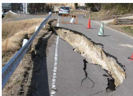
17カ所の道路・橋梁が通行止めに
