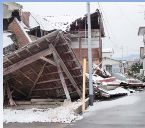
建物の50%以上が損壊したと判断される全壊家屋は28件にも及んだ
