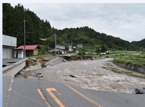
連日の雨により石田川が氾濫し 崩落した国道115号 (H27.9.10)
