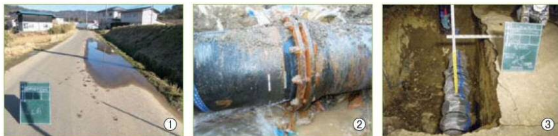
①漏水状況 ②φ450mmK型送水管受口部離脱による漏水 ③復旧完了 図 3-14. 伊達市内での被害状況(梁川町大関字下ノ内地内 口径450mm送水管の漏水)
