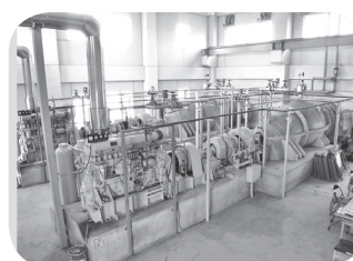
梁川第二排水機場 1 号機、2 号機ポンプ施設
