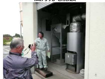
木質ペレットボイラー
