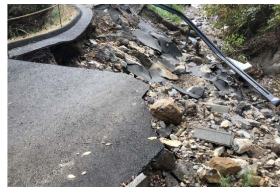
台風による豪雨で被災した道路
