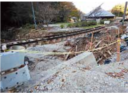
被災したあぶくま駅周辺
