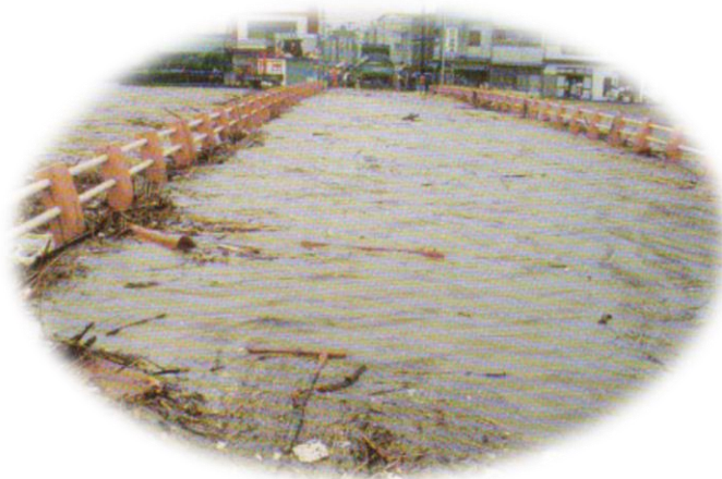
昭和61年8月5日 「8.5災害」梁川町広瀬橋が越水
