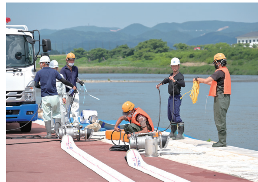
排水ポンプ車訓練
