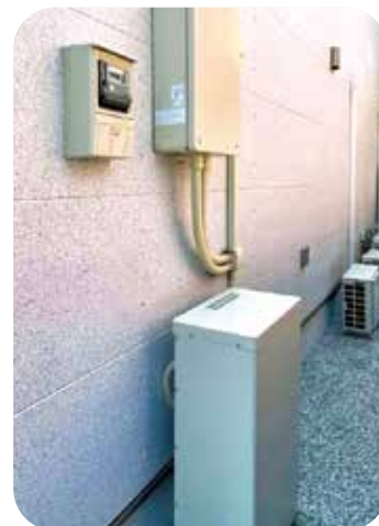
蓄電池システム
