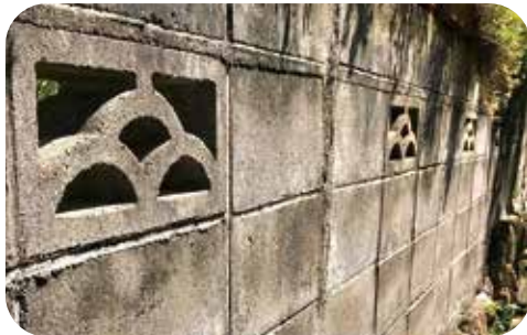
古いブロック塀
