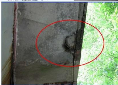
水切り未処理状況(ひび割れ、剥離、鉄筋露出あり)
