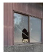
窓が割れた 管理不全空家
