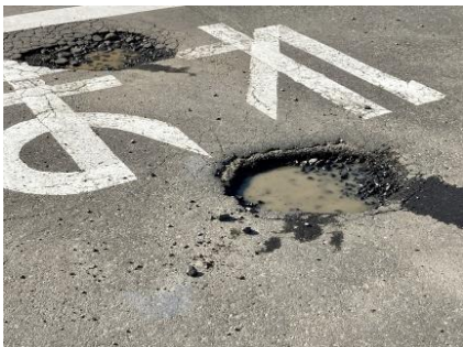
修繕が必要な道路 （イメージ）
