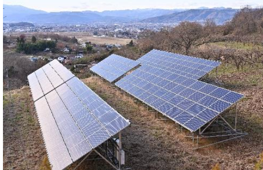
市内の太陽光パネル
