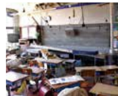
▲被災した教室
