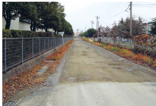
市道岡代・東野崎線の未舗装区間
