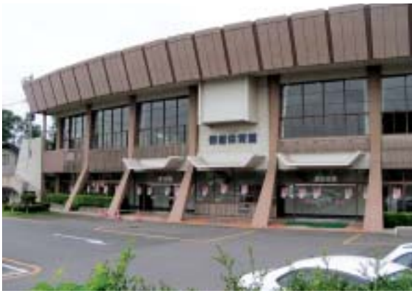
耐震診断Dランクとなった保原体育館
